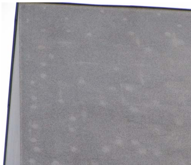
Obr. 2 Příklad kondenzace na vnějším povrchu ETICS vlivem dlouhovlnné radiace. V místě kotev (tepelné mosty s vyšší povrchovou teplotou) ke kondenzaci nedochází
