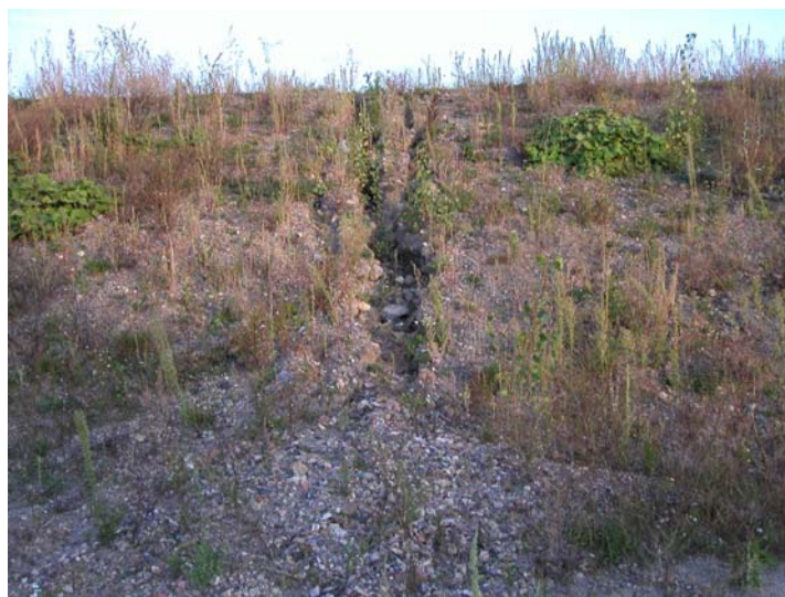
Obr. 4 Rýhová eroze na svahu navážek
