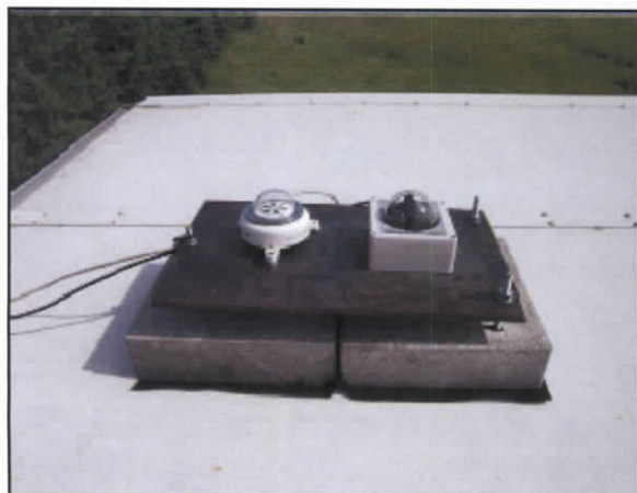
Obr. 13 Pyranometry na střeše objektu, Wilhelm Lambrecht nalevo a BF3 napravo
