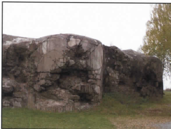
Foto 2 Čelní stěna pěchotního srubu N-S-91 „Rozhledna“ poškozená ostřelováním podkaliberními střelami Röchling
